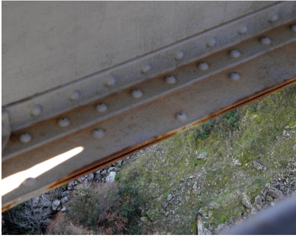
Oxydation de l'âme inférieure d'une poutre avec début de foisonnement du métal
