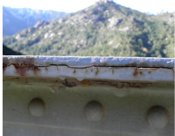
Oxydation de l'âme supérieure d'une poutre avec début de foisonnement du métal
